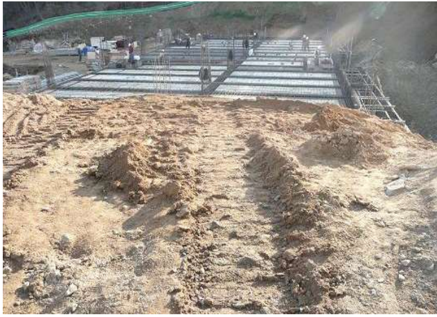
사고 현장 전경
